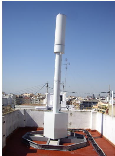
MIMETIZACIÓN DE MÁSTIL Y ANTENAS EN FORMA DE CHIMENEA, EN UNA INSTALACIÓN DE MOVISTAR
