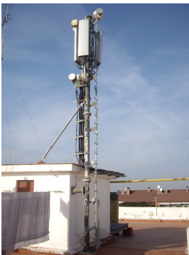
RETRANQUEO DE MÁS DE 5m DEL MÁSTIL DE ANTENAS A LA LÍNEA DE FACHADA QUE SE VE AL FONDO, EN UNA INSTALACIÓN DE ORANGE
