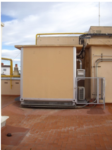
CASETA DE VODAFONE PINTADA DEL COLOR DE LA FACHADA
