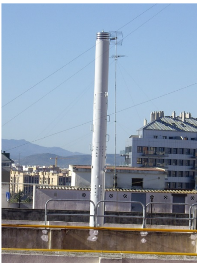
OTRO TIPO DE RADOMO EN FORMA DE CHIMENEA DE LA OPERADORA MOVISTAR
